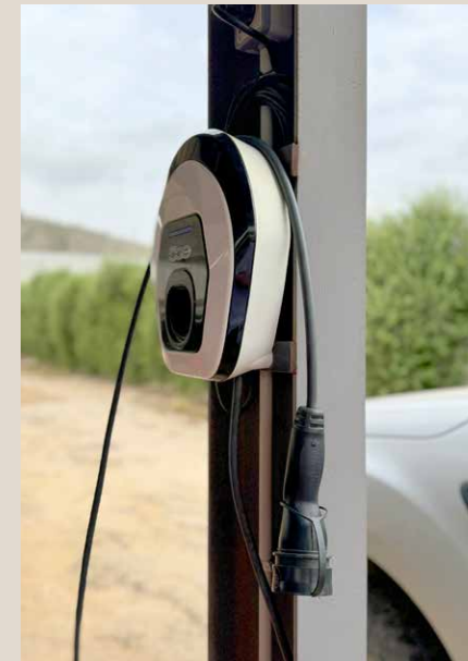
Cargador de coches eléctricos en el parking, a disposición de las visitas
